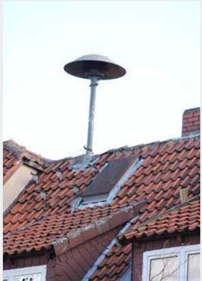
Alte Druckluft-Sirene mit sehr hohem Warnwert. Leider gab es mehrere Klagen von Nachbarn des Standortes wegen des monatlichen Probealarms oder der Nutzung als Alarmierungssystem für die Feuerwehr.
